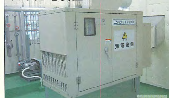
自家発電装置
